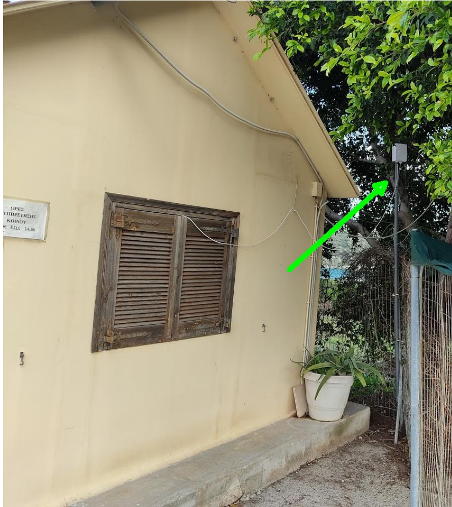
Εικόνα 25 - Τοποθέτηση LoRa Gateway (Dragino LG01-N) στο πεδίο δοκιμών.
